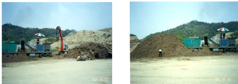
〈현장톱밥기계 설치가동 현황〉
